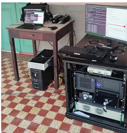
(a) Protótipo do terminal UE instalado.
