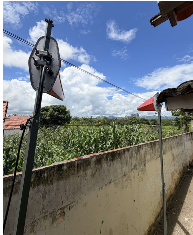
Figura 33: Antena instalada na localidade Riacho Verde.
