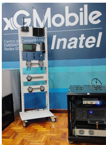
(a) Instalação do UE no Inatel.
