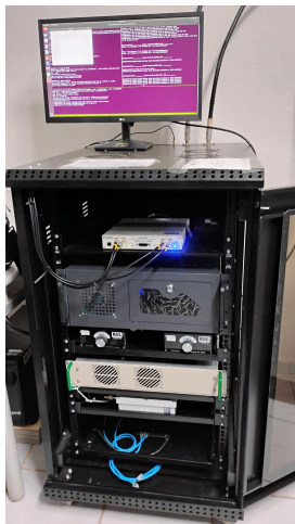
(a) BS instalada no abrigo.
