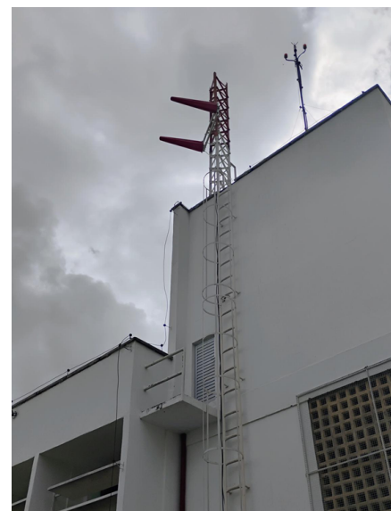
(b) Vista externa da instalação das antenas.
