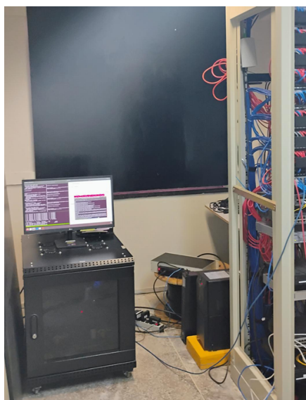
(a) Vista interna da instalação da BS.
