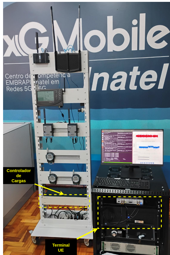
Figura 13: Controlador de cargas integrado ao rack de dispositivos de IoT.
