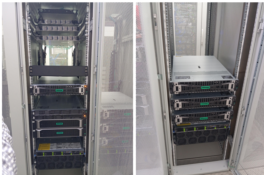
Figura 33: Visão frontal dos racks em processo de montagem - 1 à esquerda e 2 à direita.
