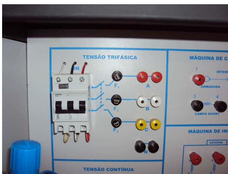
Figura 1- Disjuntor da bancada dos laboratórios de automação com os fusíveis de proteção.
